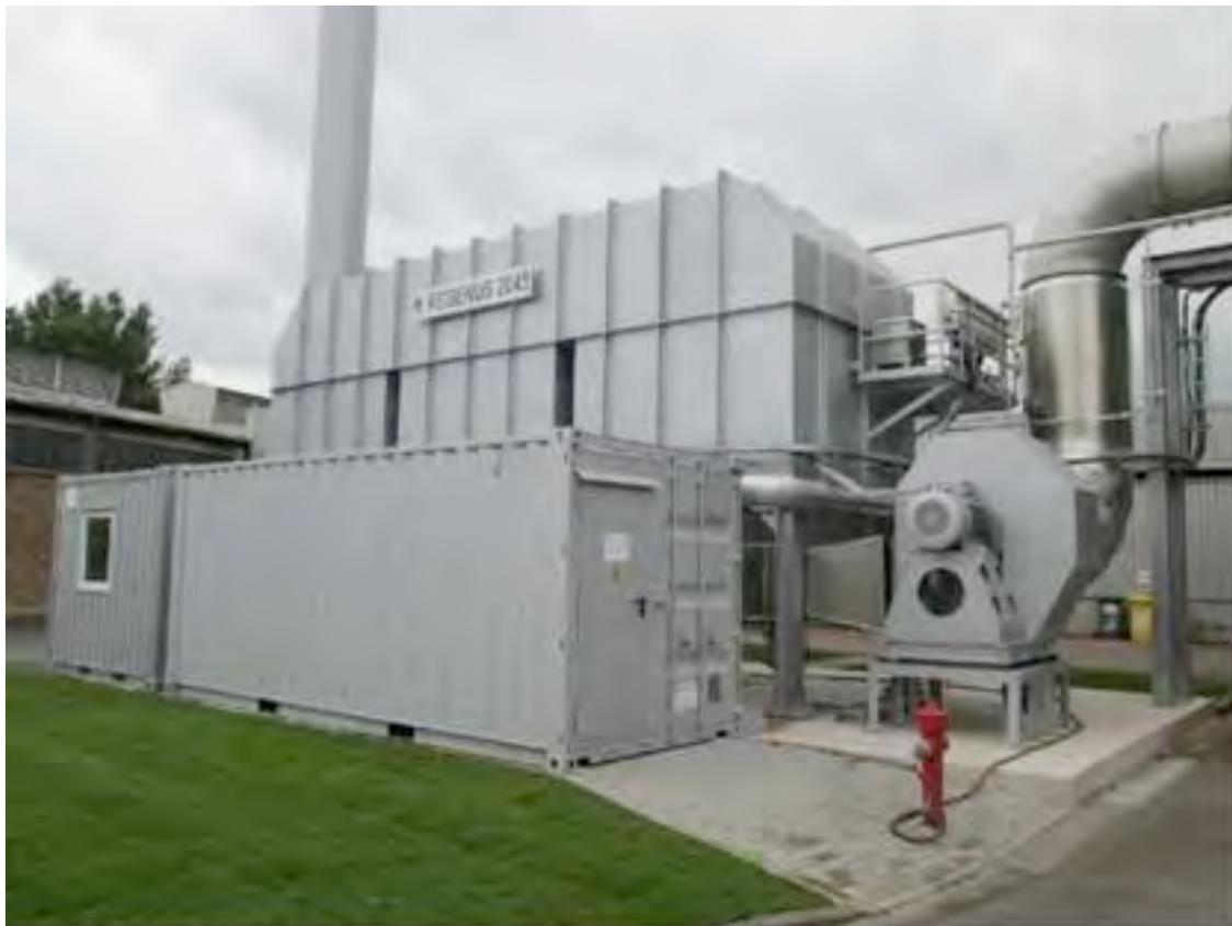
Abb.7 Abluftreinigungsanlage mit Prozessleitwarte und Einhausung der Plasmaanlage sowie Ventilatorstation
